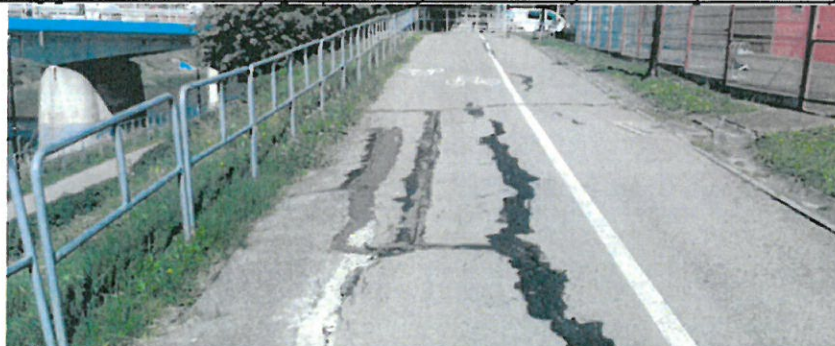
Nawierzchnia asfaltowa do remontu – ciąg pieszo-rowerowy
