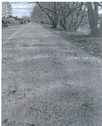
Nawierzchnia asfaltowa do remontu – ciąg pieszo-rowerowy
