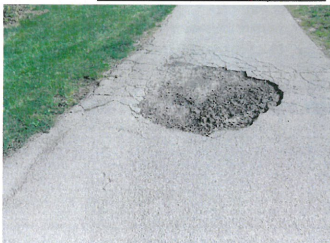
Nawierzchnia asfaltowa chodnika do remontu
