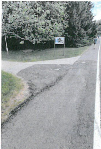
Nawierzchnia asfaltowa do remontu – ciąg pieszo-rowerowy
